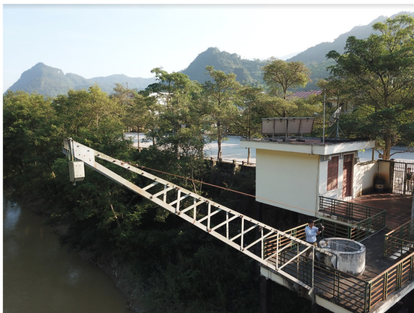
Hình 3. Hình ảnh thiết bị RQ30 lắp đặt tại trạm Tài nguyên nước Thanh Thủy, Hà Giang.
