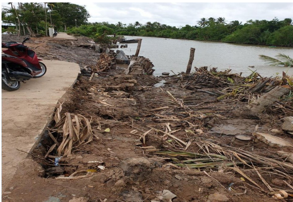
Hình 3. Vị trí sạt lở tại sông Tam Ngãi huyện Cầu Kè, tỉnh Trà Vinh.
